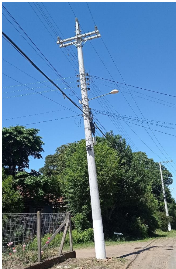
Figura 18 – Rede de energia passando em frente ao empreendimento na Rua Vicente Prieto.
