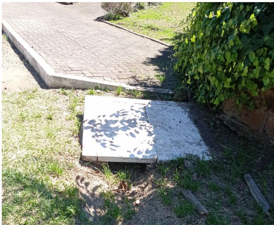
Figura 20 – Rede de drenagem pluvial na Rua Vicente Prieto.
